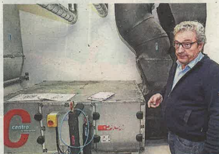
Un bâtiment passif est 180 fois plus étanche qu'un édifice à la norme basse consommation. Notamment grâce à la VMC double flux.
