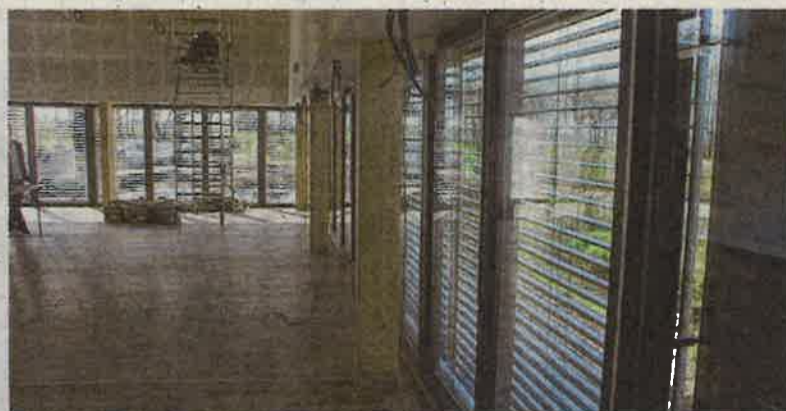
Des volets orientables selon la chaleur et la luminosité du soleil, couvrant de larges fenêtres donnant sur le sud-ouest. Cette grande salle accueillera un show-room et un lieu de réunion.
