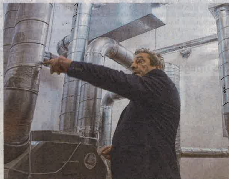
L'architecte Rolf Matz explique le fonctionnement de la ventilation spéciale, qualifiée de « poumon » du bâtiment. Des capteurs de CO 2 et d'humidité assurent une bonne qualité de l'air ambiant, tandis que la machine récupère les calories dégagées par les appareils électriques... et les humains.
