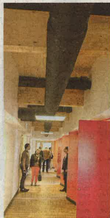
Les gaines de ventilation hyper isolées, qui permettent les entrées et sorties d'air, demeurent bien visibles pour des raisons de
